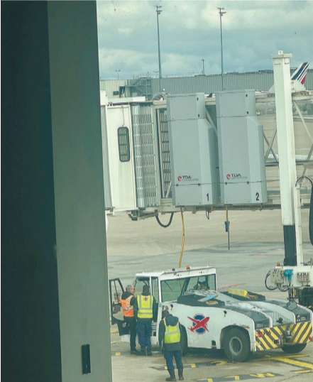
TDA- pit system פתרונות תשתיות תת רצפתית לממלי - הזנת 400 תורף למטוסים | צילום: באדיבות מנשה ברוך ושות' בע"מ
